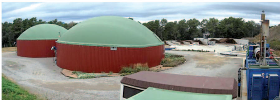
Figura 2. Instalación de obtención de biogás y compostaje de la fracción sólida del codigestato. Fuente: ARC-propia.
