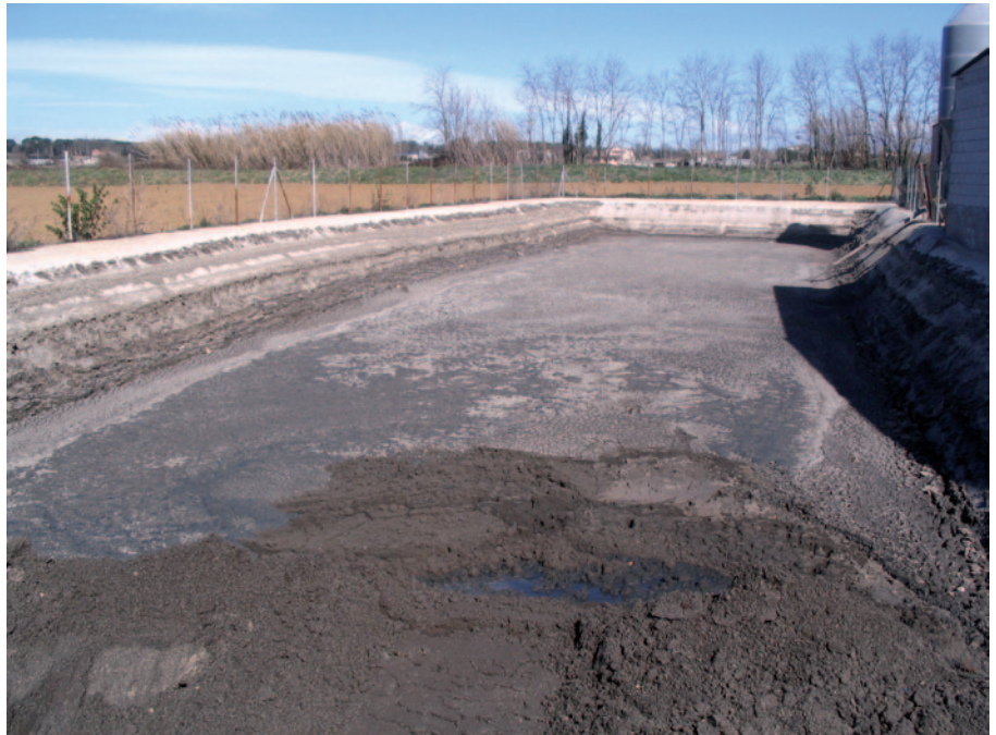
Figura 4. Balsa de digestato.
